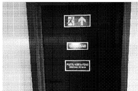
FOTO 86: 12º PAVIMENTO - SAÍDA DE EMERGÊNCIA. PORTA CORTA-FOGO
